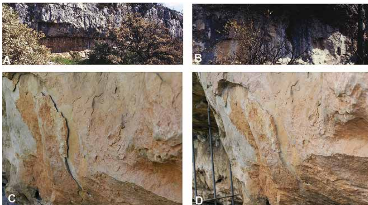
Figura 7. Abrigo de Las Clochas (Gestálgar) afectado por incendio en el año 1994. Grietas y lascado de pared del abrigo y resultado de intervención de consolidación. (IVCR+i). Fotografía: E. Guillamet.
